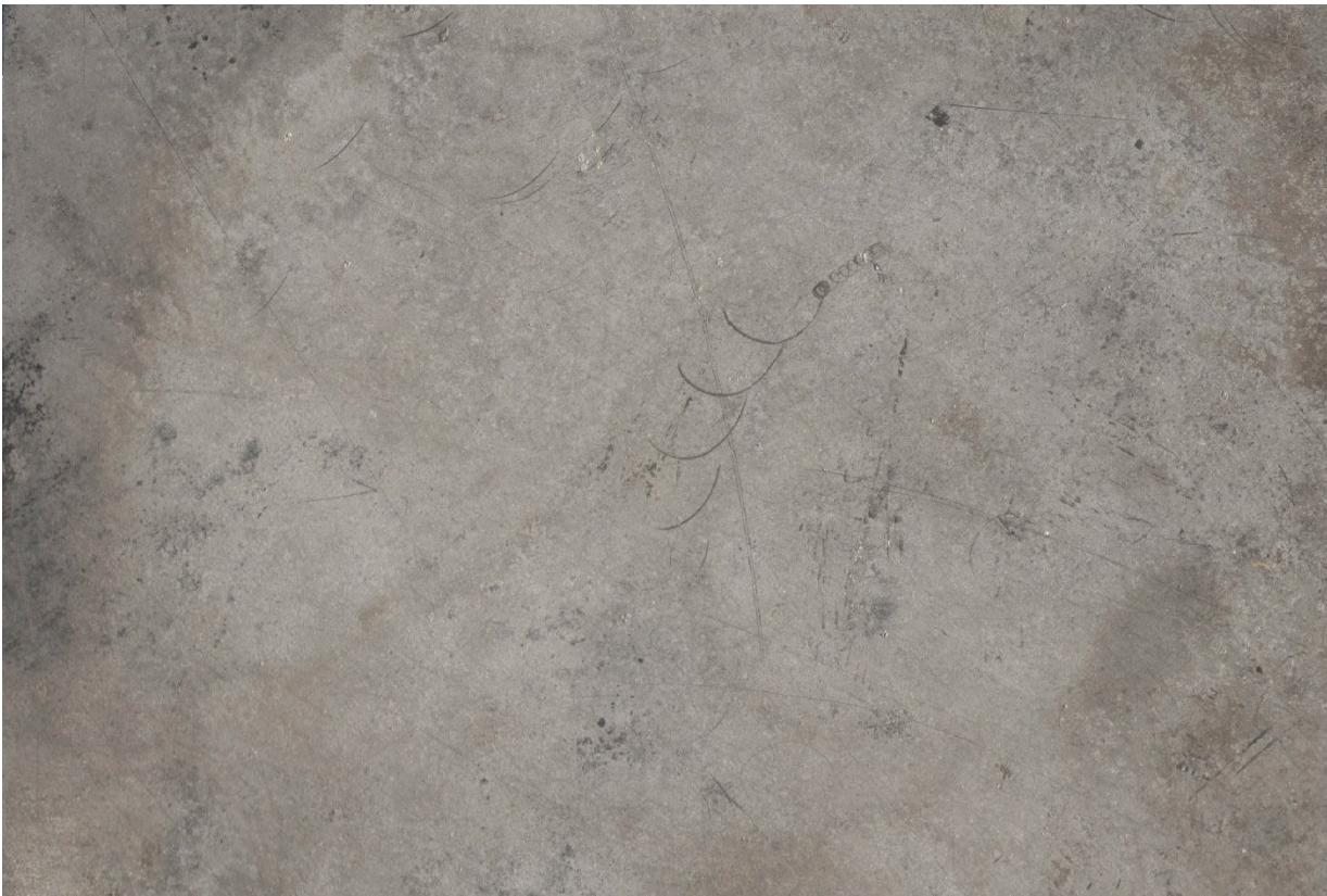
Obr. 2 Povrch kalíšku po mechanickém odstranění korozních zplodin; zdroj: autor
