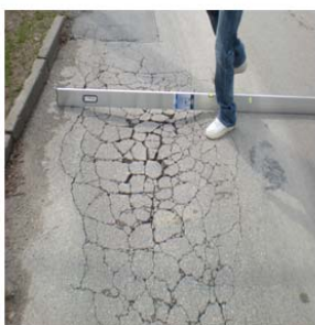
Obr. P4 Mozaiková trhlina - detail
