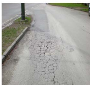
Obr. P3 Mozaiková trhlina
