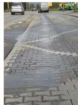
Obr. P36 Hĺbkové nerovnosti dlažbového krytu
